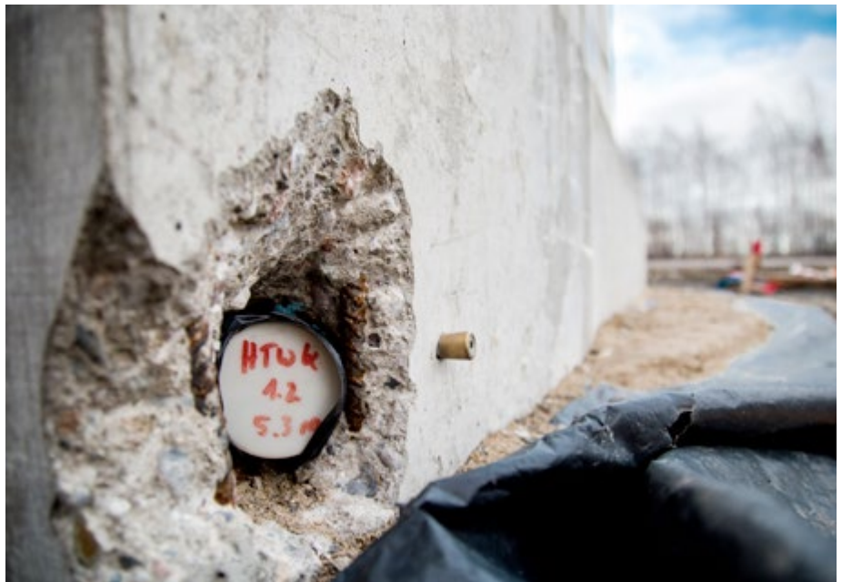
In und unter den Betontürmen wurden weitere Messsysteme installiert. Über diesen Kanal konnten die Wissenschaftler die Verformung der Belastungsbauwerke messen.
